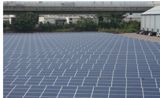
泉大津工場に設置の太陽光発電システム
