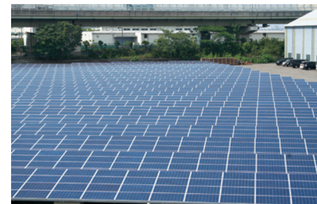
泉大津工場に設置の太陽光発電システム
