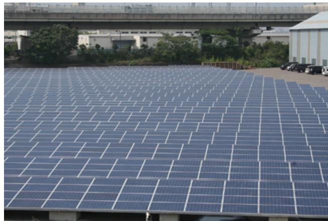
泉大津工場に設置の太陽光発電システム
