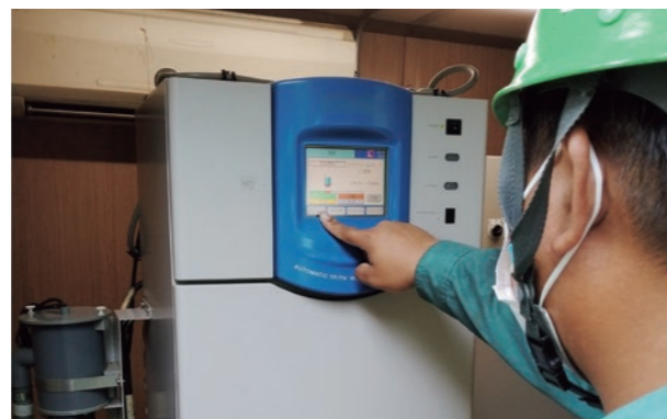
市川工場 全窒素・全りん測定装置
