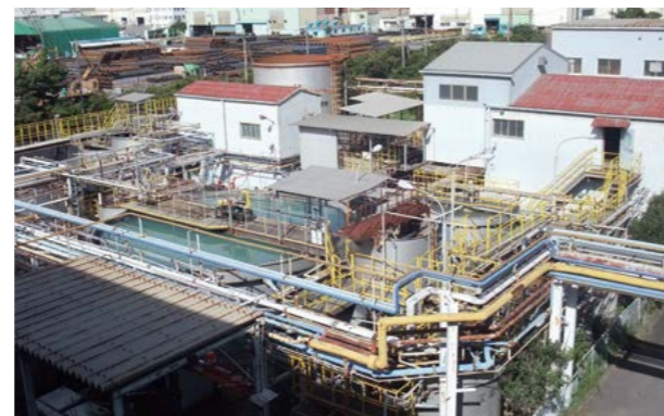
市川工場 総合廃液処理設備
