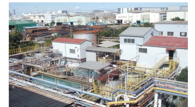
市川工場 総合廃液処理設備
