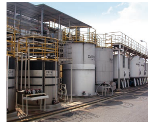
呉工場 表面処理工場廃液処理設備
