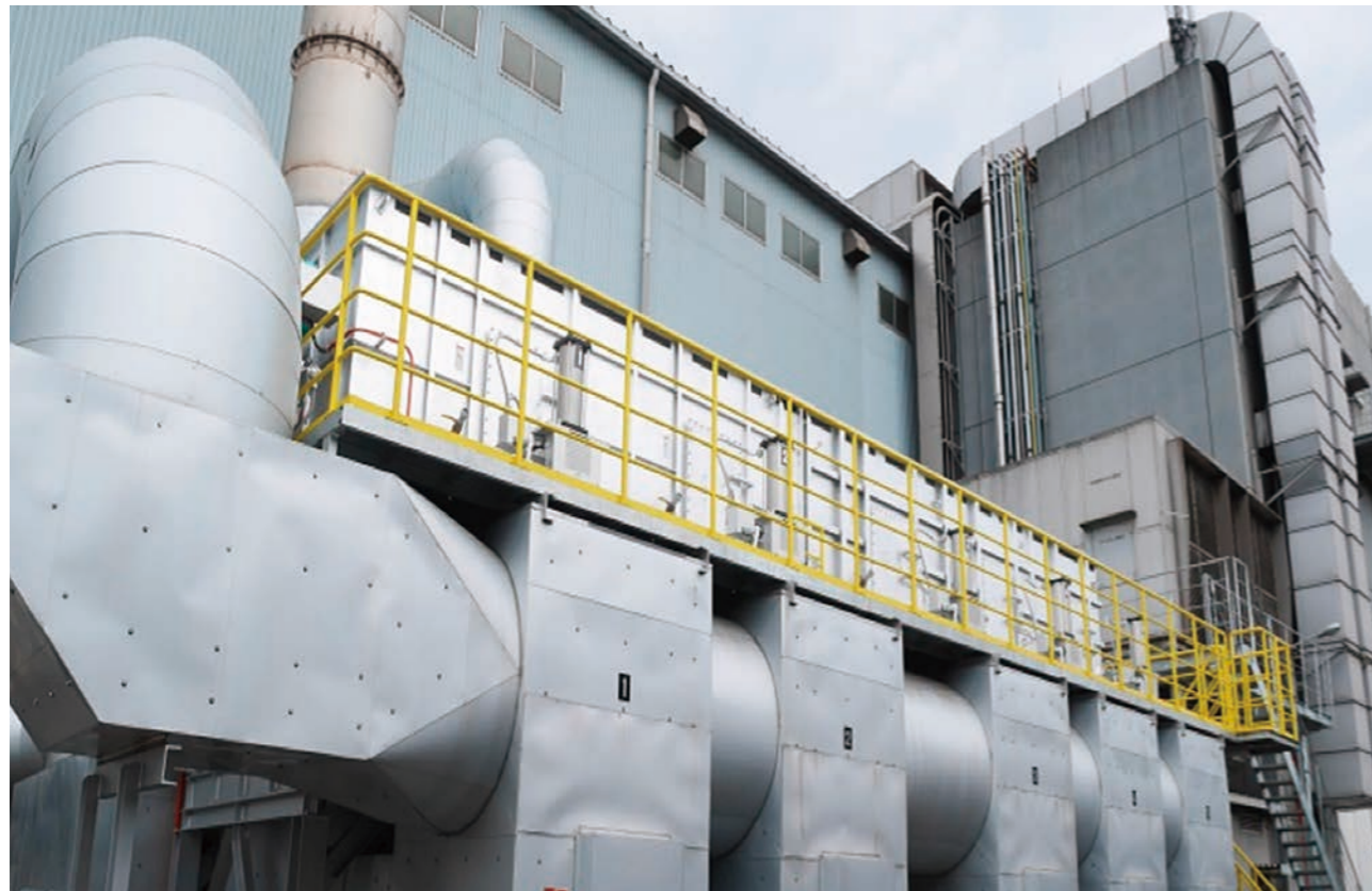
大阪工場 No.5カラーライン脱臭装置 高い排ガス処理能力と熱効率で、環境保全に貢献しています
