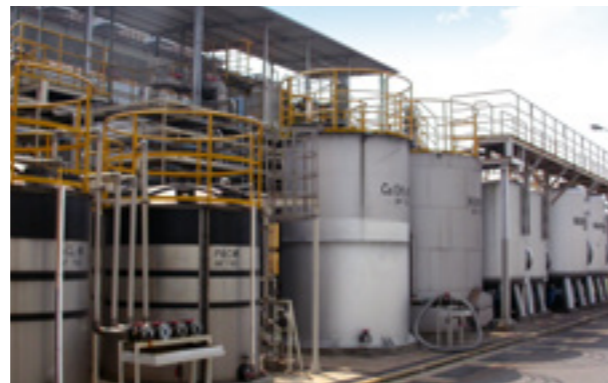
呉工場 表面処理工場廃液処理設備
