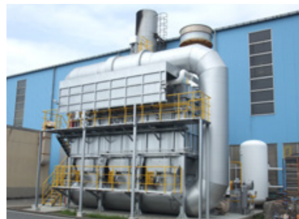
市川工場 No.4カラーライン脱臭装置 高い排ガス処理能力と熱効率で、環境保全に貢献しています
