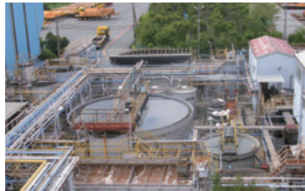
市川工場 総合廃液処理設備
