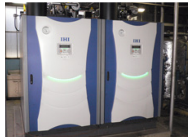
呉工場 第2工場ボイラー更新 高効率ボイラーの導入により、CO 2 の削減に貢献しています
