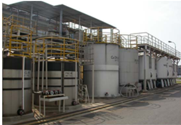
呉工場 表面処理工場廃液処理設備
