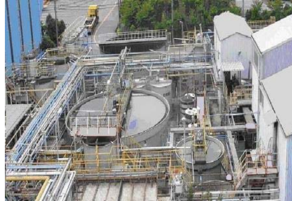
市川工場 総合廃液処理設備
