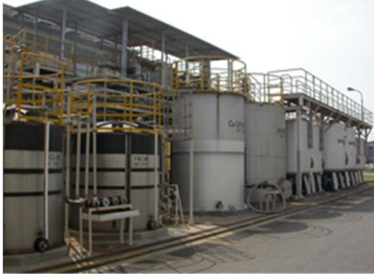
呉工場 廃液処理設備
