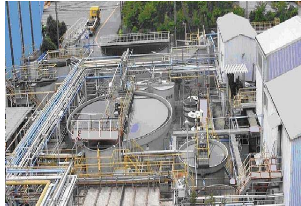
市川工場 総合廃液処理設備
